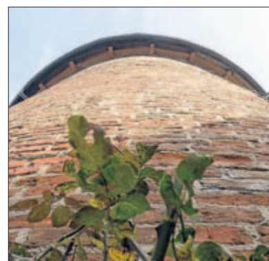
Zwölf Meter ragt der Fangelturn – ein Bestandteil der Stadtmauer – in die Höhe.
